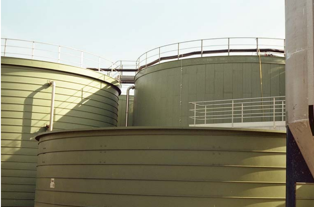
Figura 5 – (Da esquerda para a direita) Tanque de aeração (d), Decantador (e), Reservatório de acumulação (b)
