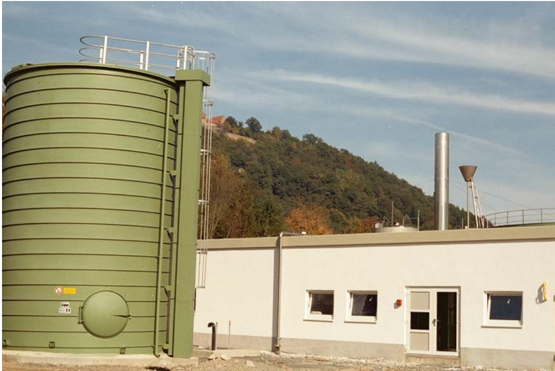
Figura 7 – Gasômetro (h) e casa da caldeira e controle do biogás
