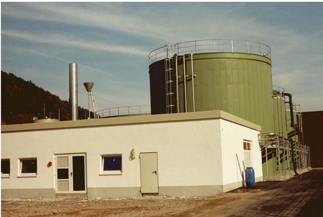
Figura 6 – Digestor (c) e casa da caldeira e controle do biogás
